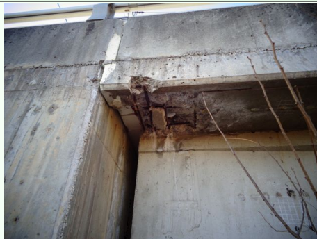
사진5 - 바닥판 파손 및 철근노출
