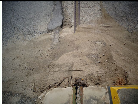
사진1 - 신축이음 본체 이물질퇴적
