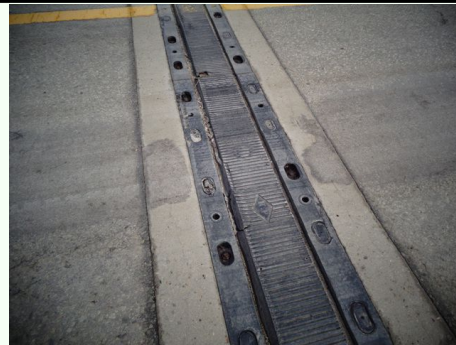
사진2 - 신축이음 고무재 파손
