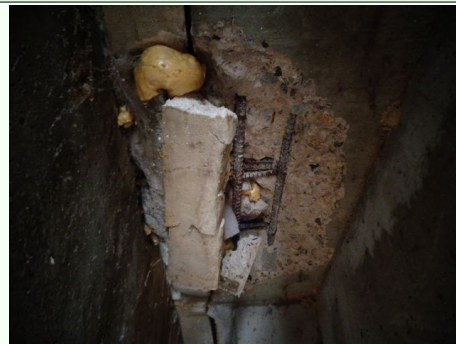
사진6 - 바닥판 파손 및 철근노출
