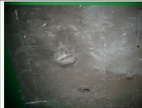
사진7 - 바닥판 균열 및 백태
