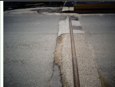
사진3 - 신축이음 후타재 파손
